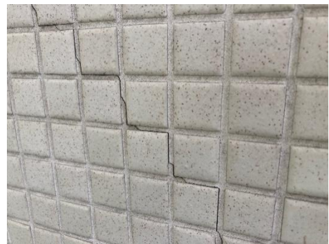
照片 3.3.1 磁磚接縫處龜裂
