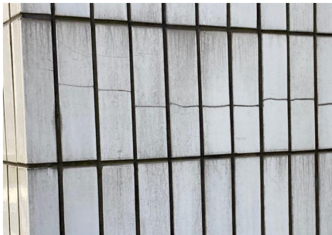
照片 2.2.2 磁磚龜裂
