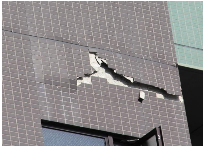
照片 2.2.4 從砂漿黏著材剝落的案例（周圍出現浮凸）
