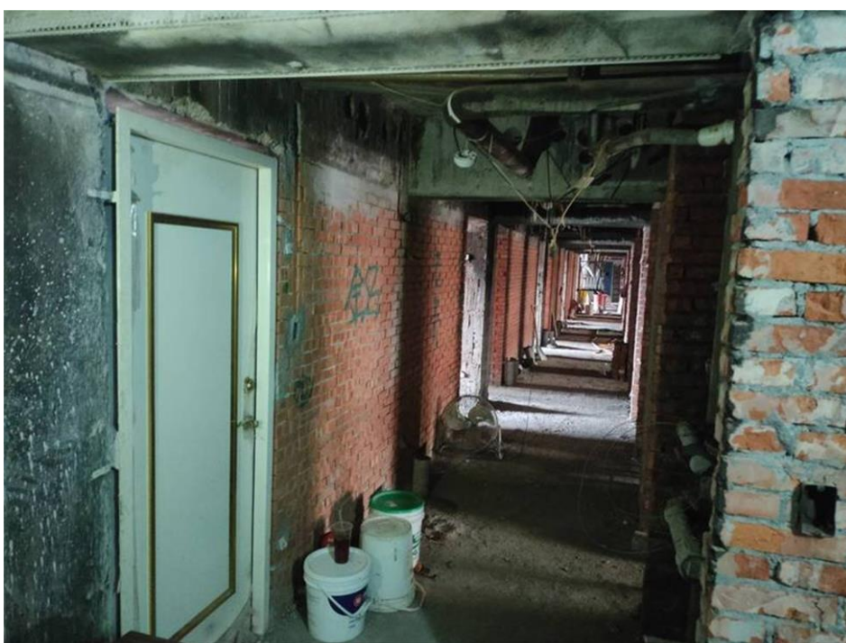
高市新興區某住商大樓頂樓擅自打除樓板增設隔間，且樓梯間堆放大量雜物等，嚴重危害公共安全，市府人員前往聯合稽查。(圖消防局提供)
