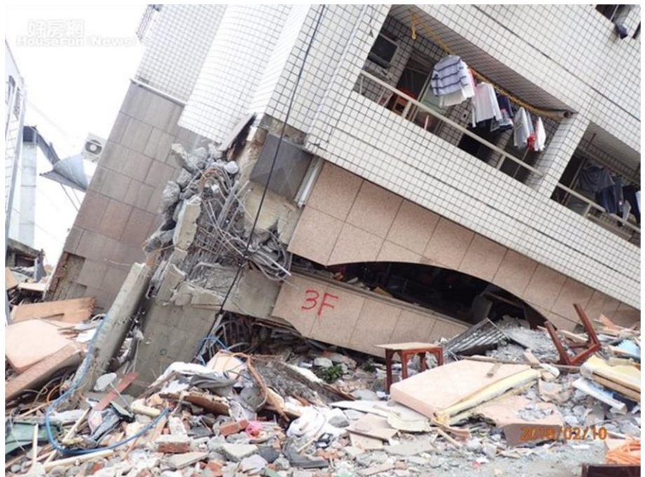
地震大樓倒塌案件中，90% 以上屬於 1、2 樓層柱破壞爆裂倒塌情況。照片戴雲發提供
