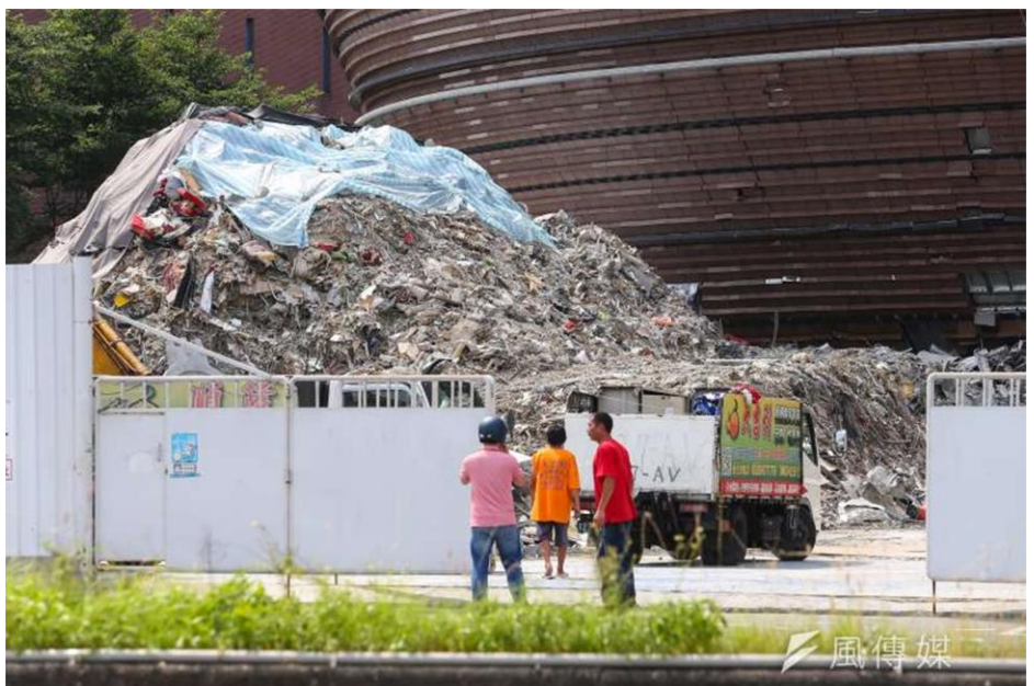
京華城拆除工程發生一起事故，一名拆除工人遭活埋致死。(資料照，顏麟宇攝)
