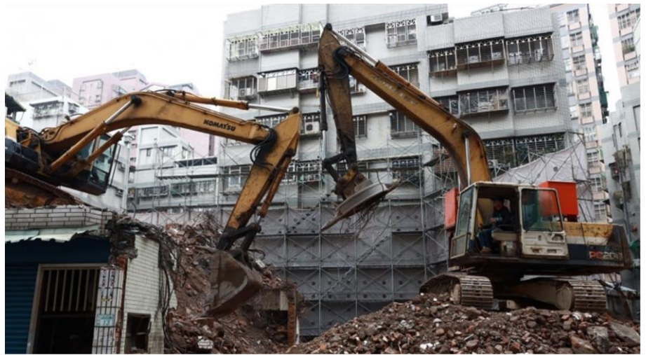
位於新北市五股區五福路上一處海砂屋屋況不佳，住戶申請新北市防災建築再生自治條例，三月初拆除。(城鄉發展局提供)
