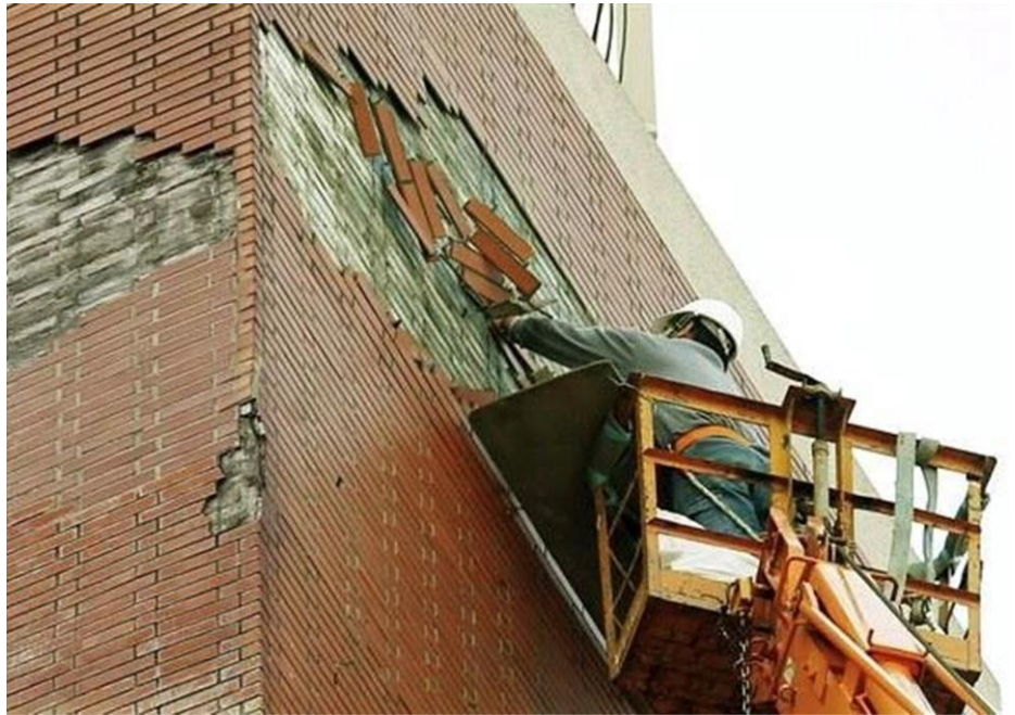
北市建築物外牆修繕每棟補助上限 10 萬元，遲遲不修繕者恐遭重罰 6 至 30 萬元。圖 / 台北市建管處提供
