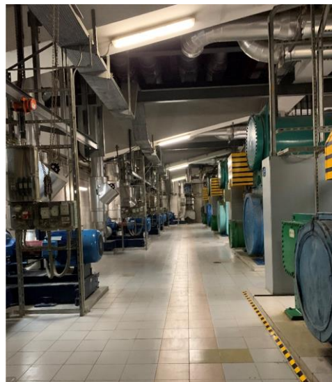
機房維持整潔，設備運營 20 年維持如新
