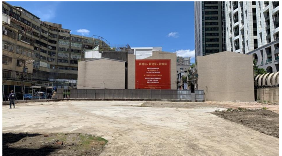
由唐璽建設打造的全台首件危老案，基地位於新埔捷運站 3 號出口，現況已將老屋拆除，未來即將化身成為耐震的新式集合住宅。圖：唐璽建設提供
