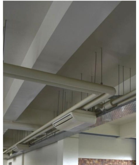
下關市豐北生涯學習中心 盡量使用明管便於日後維護更新
