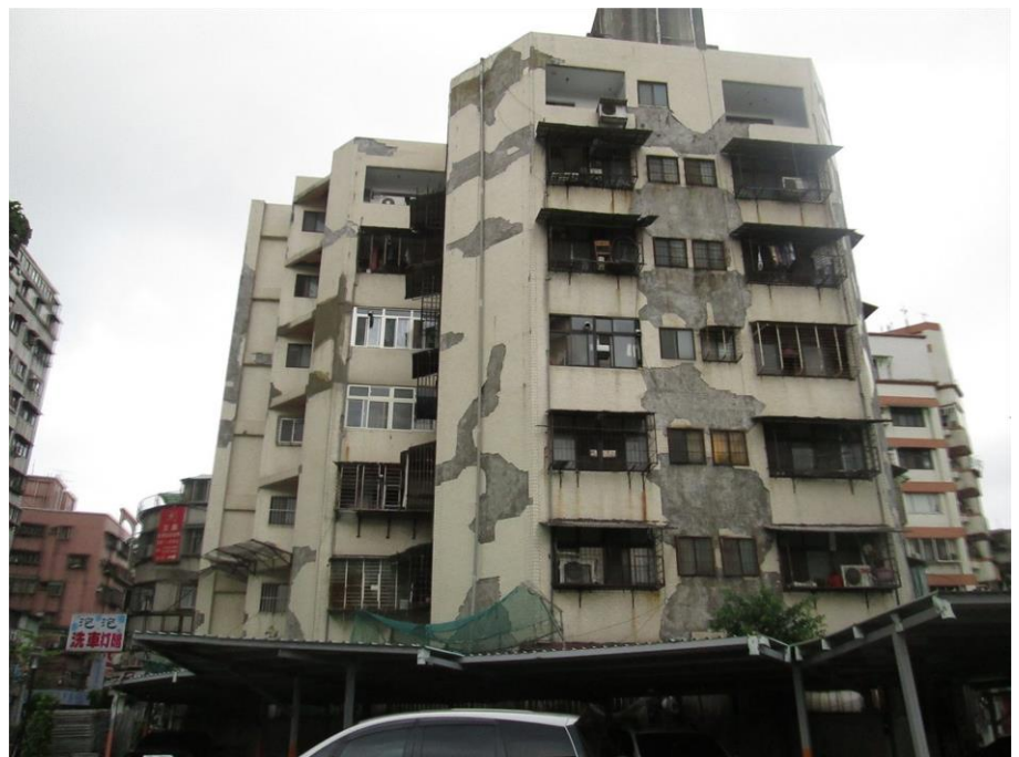
新北市永亨大樓施工前，外觀老舊，有礙市容。圖 / 都更處提供
