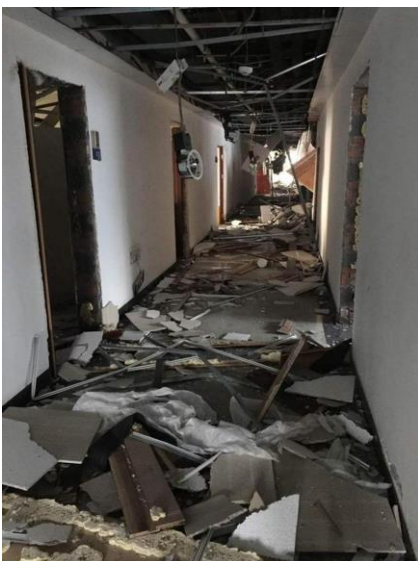
距離爆炸現場約 500 米的建築物毀損嚴重。翻攝騰訊網
