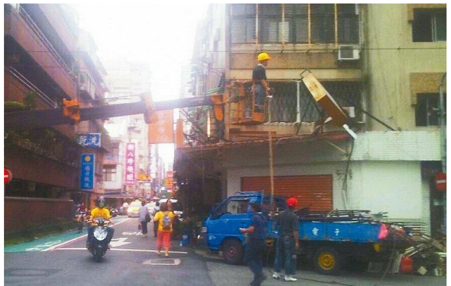
街頭解危 北市遭蘇迪勒破壞的招牌數字創下歷年新高，建管處派出逾 2000 人次拆除 1190 件危險招牌。 圖 / 建管處提供
