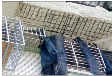
三重海砂屋鋼筋裸露鏽蝕，市府協助劃定「都市更新地區」，把住戶同意比例門檻降低為 2 分之 1。(都更處提供)
